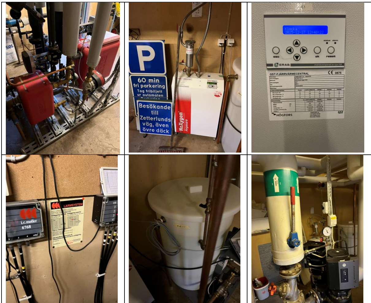
Bilder från undercentral samt larmsystem för läckage
