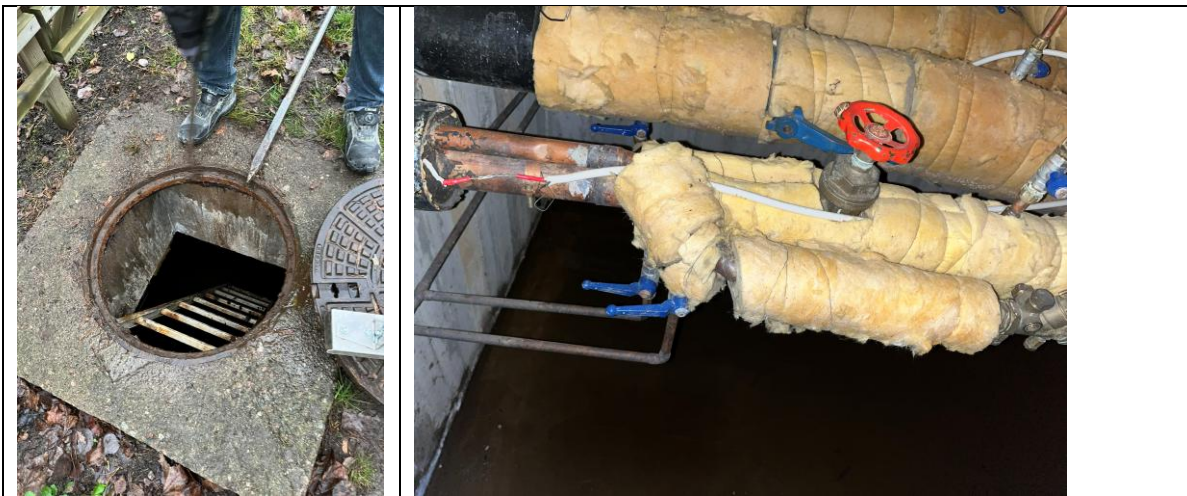
Fördelningskammare Samfällighetsföreningen Zetterlundsvägen
