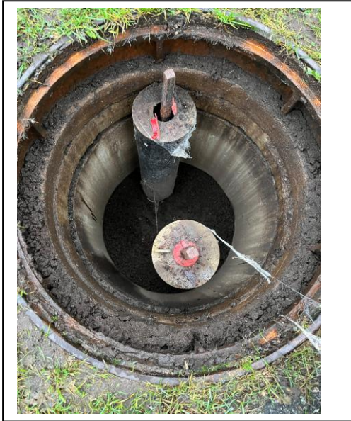
Brunn sektioneringsventil Samfällighetsföreningen Zetterlundsvägen
